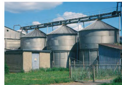
Abbildung 3: Wellblechsilos haben einen 3-4 cm breiten Luftspalt zwischen Wand und Silodach, sind aber auch zwischen den Blechen oft nicht gasdicht, weil Dichtungsgummis im Laufe der Jahre porös und rissig werden oder ganz fehlen
