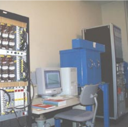
Abb. 5: Messraum mit der Low-level-Alpha-Spektrometrie (links im Vordergrund) sowie zwei Low-level-Gamma-Spektrometern mit Bleiabschirmungen (in blau).
